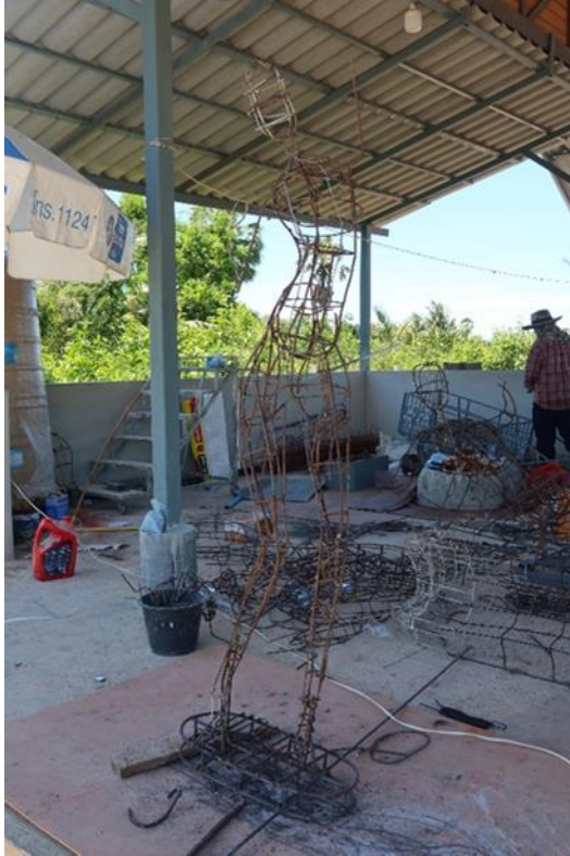
ภาพที่ ๕ : ภาพระหว่างการติดตามการก่อสร้างระยะที่ ๑
